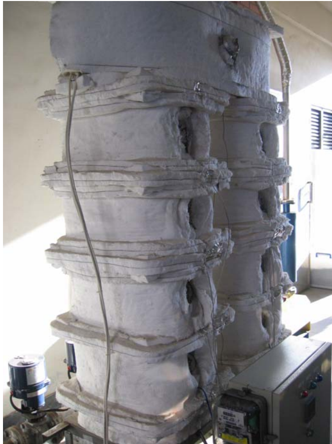
照片 3.1：蓄熱式焚化爐（RTO）設備
